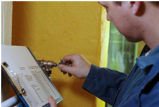
Einstellen des Thermostatventils im Rahmen des hydraulischen Abgleichs durch eine Fachfirma. Quelle: www.co2online.de / Alois Müller
